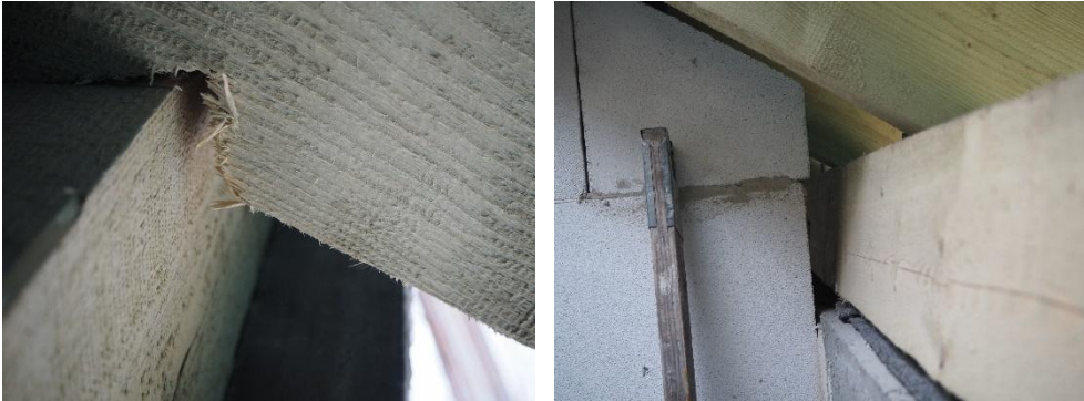
Rys. 8. Przykład awarii połączenia krokiew-murlata z obróceniem murlaty. Połączenie z użyciem wkrętu ciesielskiego.
