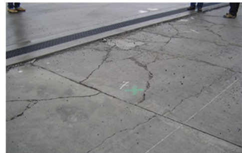
Rys. 4. Spękania płyty w punkcie badawczym nr 7.
