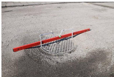
Rys. 6. Widok zanizzonej o 6 cm pokrywy studni.
