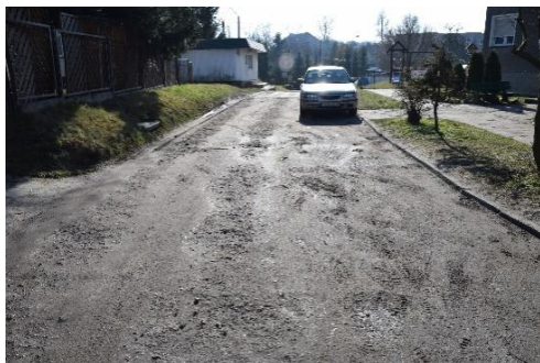
Rys. 3. Widok degradacji powierzchniowej.
