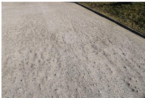
Rys. 4. Widok zniszczonej tekstury nawierzchni.
