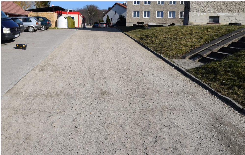
Rys. 9. Widok uszkodzonej nawierzchni betonowej.
