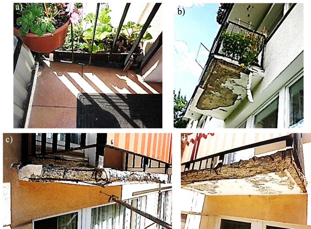
Rys. 6. Balkony nr 5, 6 i 7 w budynku wielopłytowym w systemie OWT-67: a) widok ogólny balkonu nr 5 po dwóch remontach bieżących i jednym kapitalnym z wykonaniem okładziny ceramicznej, b) balkon nr 5 – spód płyty balkonu, złuszczenie i ubytki po trzeciej naprawie (remoncie kapitalnym), mimo wykonania od góry okładziny ceramicznej, c) balkon nr 6 – ubytki betonu konstrukcyjnego na krawędziach płyty, d) ubytki betonu konstrukcyjnego na krawędziach płyty i zacieki na całej powierzchni płyty balkonowej oraz ociepleniu trójwarstwowej beko-ściany.
