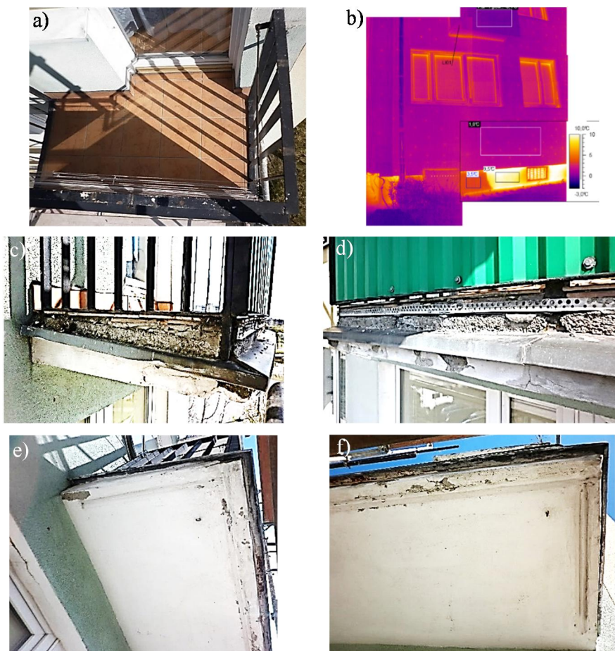
Rys. 3. Balkon nr 2 w budynku wielokoblockowym WBLŻ, po 40 latach użytkowania: a) widok ogólny okładziny balkonu, b) termogram, c) odkrywka boku płyty balkonowej i docieplonej ściany osłonowej, d) odkrywka czoła balkonu z płytą spadkową i płytą wyrównującą spadek pod okładziną ceramiczną, widoczne wykwity solne e) zacieki na styku ściany z płytą balkonową i złuszczenie nanizanej farby emulsyjnej w glicie okna pod balkonem będące skutkiem braku fragmentu obróbki blacharskiej (patrz rys. 2a), e) ubytki krawędziowe płyty balkonowej, co potwierdza brak szczelności izolacji na styku izolacja-obróbka i nieskuteczność liftingu.
