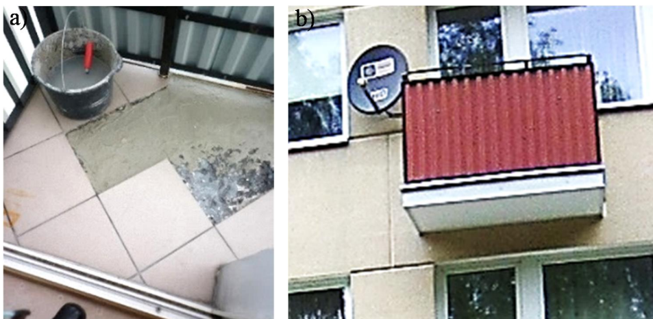
Rys. 9. Balkon nr 8 w budynku wielopłytowym w systemie OWT-67 – balkon poddany bieżącej konserwacji: a) zmyta deszczem izolacja pozioma podczas wykonywania robót okładzinowych, b) efekt wizualny po czwartej naprawie bieżącej balkonu wspornikowego.
