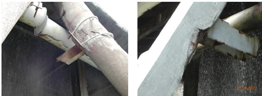
Rys. 7. Przykład nieprostoliniowego słupa (z lewej) i uszkodzenia spowodowanego niewłaściwym osadzeniem wspornika (z prawej).
