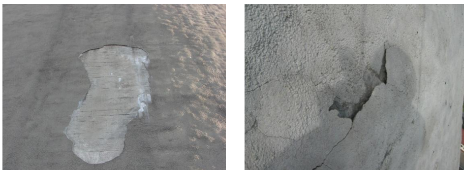
Rys. 19. Przykłady odspojen cienkiej warstwy niezbrojonego betonu natryskowego.
