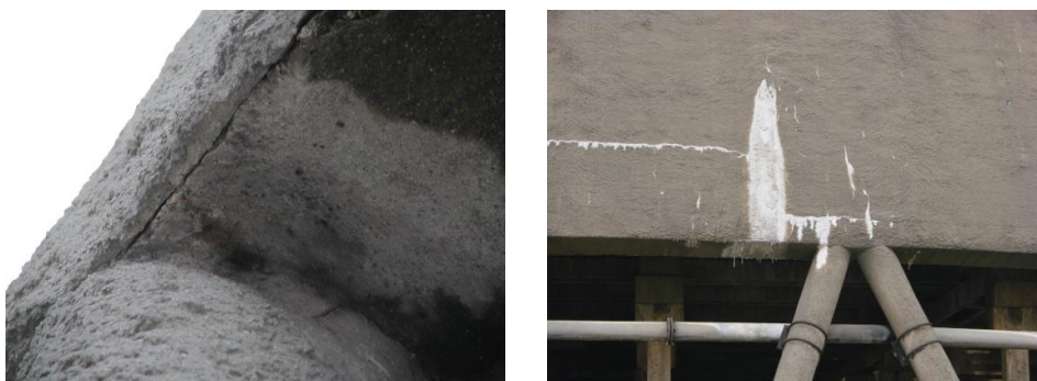
Rys. 20. Odspojenie warstwy betonu natryskowego (z lewej); ślady wycieków wody (wymyte sole wapnia) spod odspojonej warstwy betonu natryskowego (z prawej).
