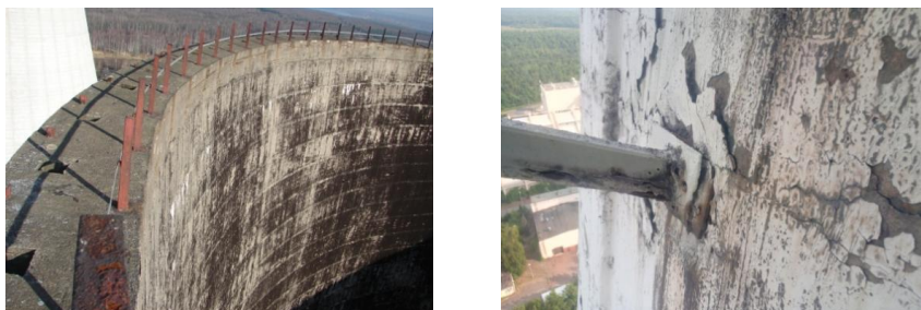
Rys. 18. Przykład usunięcia przerdzewiałej bariery (z lewej) oraz braku śruby mocującej wspornik pod drabiną włazową (z prawej).
