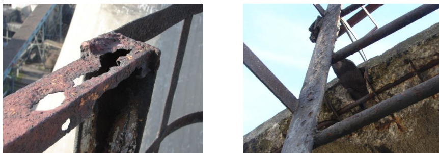
Rys. 17. Przykłady korozji bariery na górnej galerii i górnego fragmentu drabiny włazowej.
