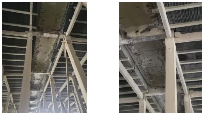
Rys. 16. Przykłady uszkodzeń korozyjnych konstrukcji wsporczych kolektorów wody.
