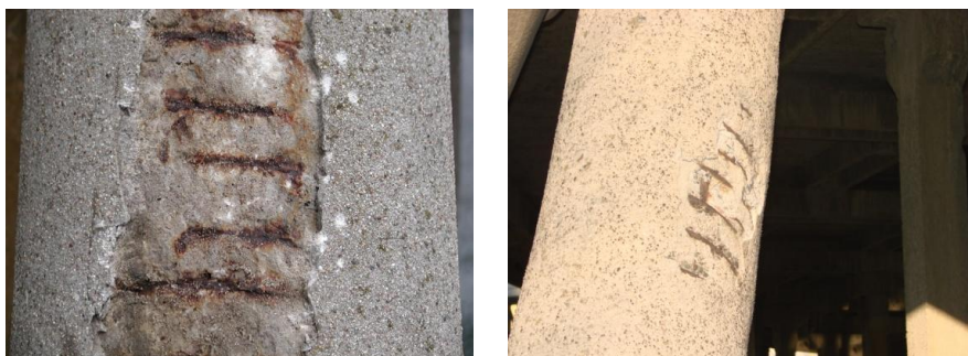
Rys. 6. Przykłady korozji zbrojenia wskutek zbyt cienkiej otuliny (po prawej nieudana naprawa).
