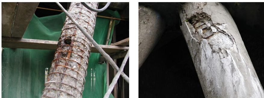
Rys. 5. Przykłady wykonania słupów z betonu bardzo złej jakości.
