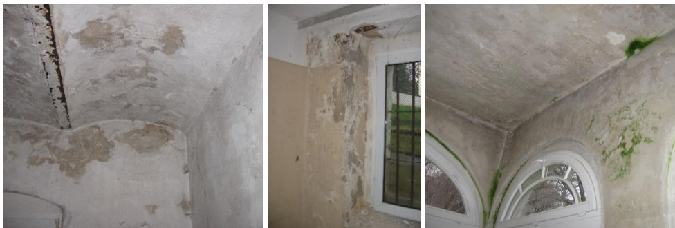
Fot. 9–11. Zawilgocone ściany, stropy i nadproża piwnic i parteru (fot. B. Nowogońska).
