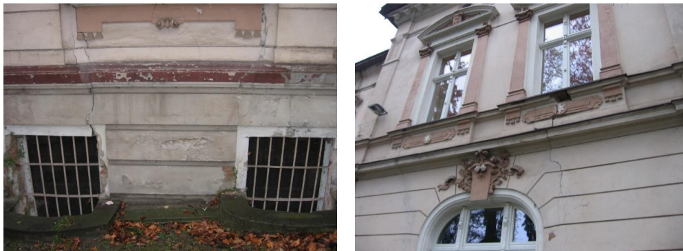
Fot. 7, 8. Fragment pionowych rys po obu stronach otworu okiennego parteru i dalej do okapu na elewacji południowo-wschodniej (fot. B. Nowogońska).
