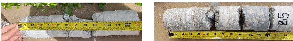
Rys. 9. Widoki pobranych odwiertów rdzeniowych ze stropu garażu. Źródło:[9].
