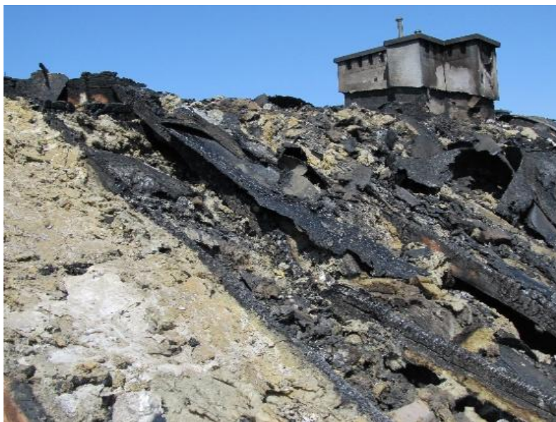
Rys. 3. Uszkodzona wełna mineralna poszycia dachowego (fot. własna).
