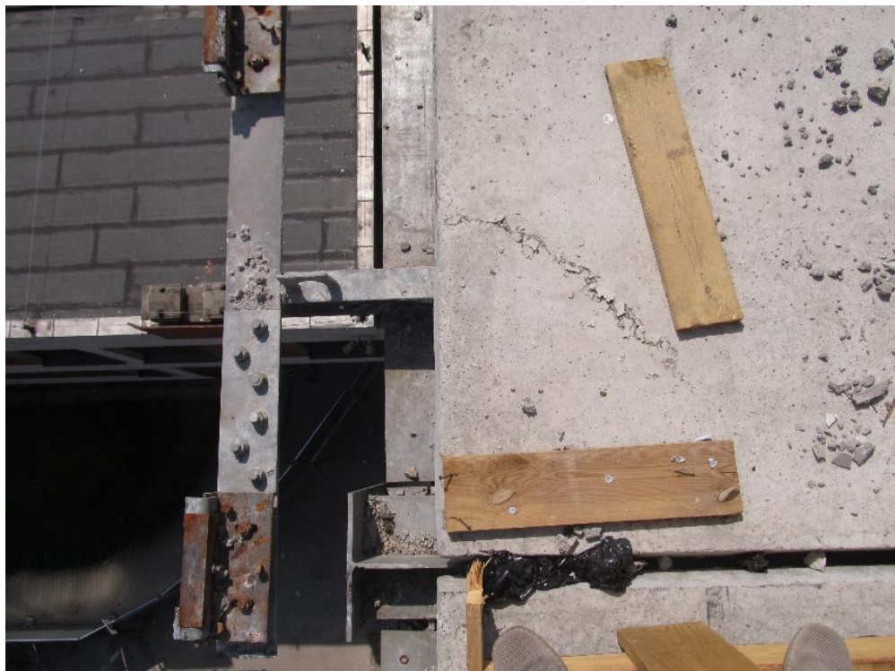
Rys. 8. Widok pękniętego narożnika prefabrykatu stropodachu (oś 3 oraz frontowa oś A) (fot. własna).
