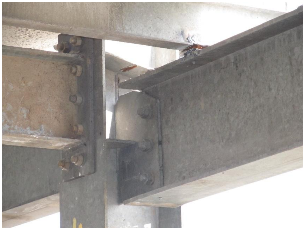
Rys. 9. Widok zerwanego węzła w poziomie stropu V kondygnacji (oś 3 oraz frontowa oś A) (fot. własna).
