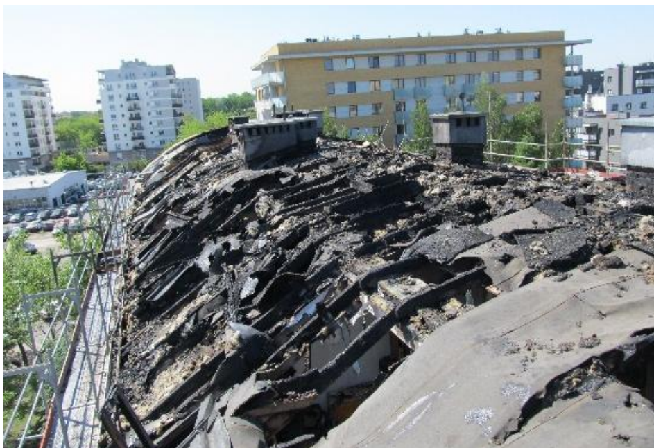
Rys. 2. Uszkodzony dach kolebkowy nad lokalami klatek VII i VIII (fot. własna).
