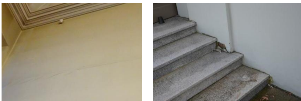
Rys. 8. Uszkodzenia po wykonanym remoncie. Zarysowanie i pękanie źle dobranych powłok malarskich (po lewej), uszkodzenia przy wyremontowanych schodach bocznych (po prawej).
