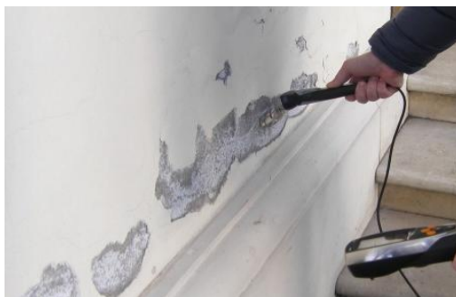
Rys. 7. Zawilgocenia, wysolenia, ubytki tynku i farby – obiekt w Rybnej.
