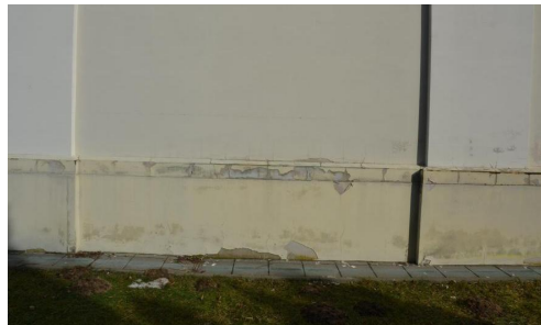
Rys. 6. Zarysowania, spękania i silne zawilgocenia cokołu – obiekt w Skórcu.
