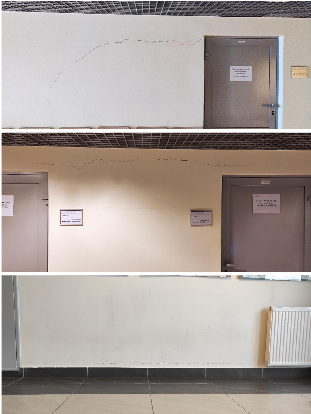
Rys. 4. Przykładowe zarysowania na ścianach działowych korytarzy.
