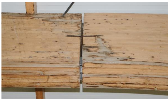
Rys. 7. Złuszczenie powłoki ochronnej na dźwigarze głównym.
