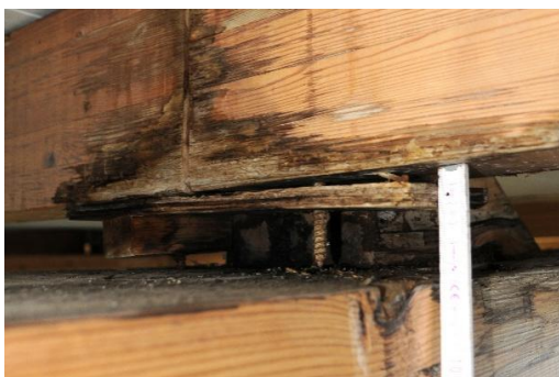
Rys. 9. Wyrwanie wkrętu kotwiącego płatwę dachową do dźwigara.
