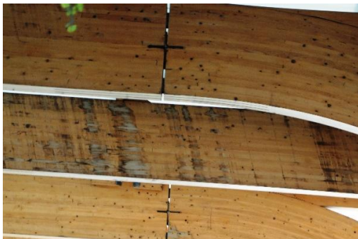
Rys. 8. Złuszczenie powłoki ochronnej na dźwigarze pośrednim.
