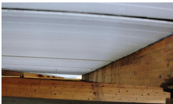
Rys. 6. Zjawisko klawiszowania warstwowych płyt dachowych.
