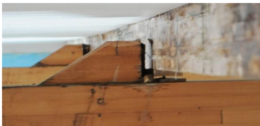
Rys. 10. Wolne przestrzenie w stykach pomiędzy płatwią a dźwigarem i płatwią a elementem oporowym.
