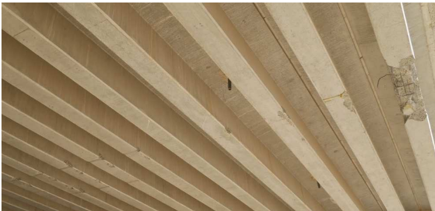
Rys. 1. Uszkodzenia dźwigarów wewnętrznych
