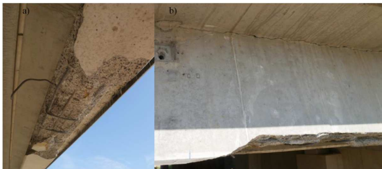
Rys. 3. Ubytki w dźwigarze skrajnym: a) widok od dołu, b) zarysowanie pomiędzy półką górną a środnikiem
