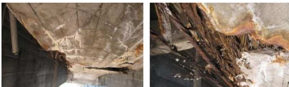
Rys. 12. Korozja kabli i pęknięcie baterii zewnętrznej w paśmie południowym przęsła zachodniego
