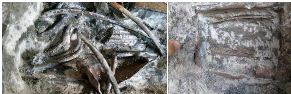
Rys. 8. Popękane kable odsłonięte w czasie oględzin przęsła we wrześniu 2016
