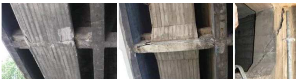
Rys. 14. Ścięte poprzecznice w przęśle zachodnim
