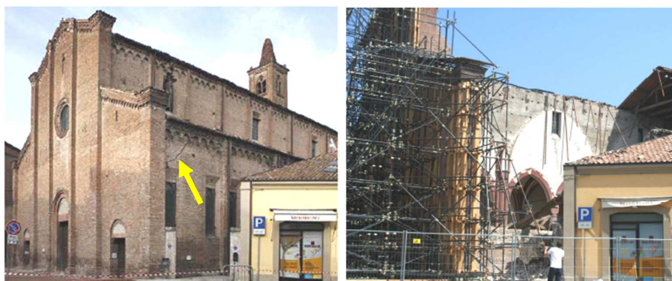
Rys. 1. Uszkodzenie ściany kościoła San Francesco w Mirandoli (Włochy) spowodowane głównym wstrząsem sejsmicznym (po lewej) i zniszczony kościół po wstrząsie wtórnym (po prawej) [2]
