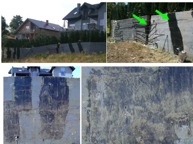
Rys. 10. Pęknięta ściana betonowa na aktywnym osuwisku, zabezpieczona w trybie awaryjnym wklejonymi prętami stalowymi i siatkami z włókna szklanego przyklejonymi na polimerze PS [18]
