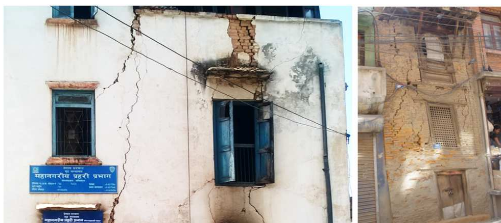
Rys. 2. Uszkodzone budynki mieszkalne po trzęsieniu ziemi w Nepalu: w Patan (po lewej) i w Katmandu (po prawej)
