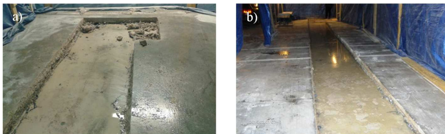
Rys. 3. a) wypływ i zbieranie się wody w odkrywce oraz b) wypełnione wodą koryto odkrywki w podłodze garażu na poziomie -2
