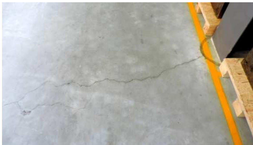
Rys. 1. Przykładowe pęknięcie przy słupie
