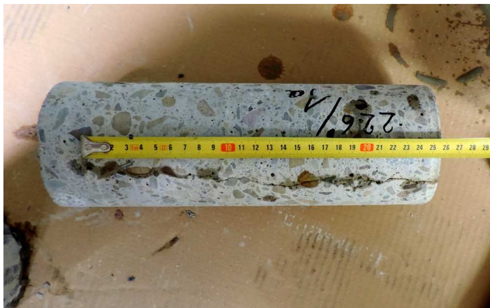
Rys. 3. Próbką pobrana w miejscu zarysowania (droga transportowa)
