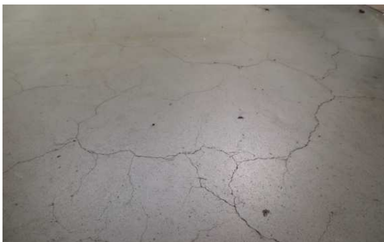
Rys. 4. Nieregularne pęknięcia w centralnej części posadzki
