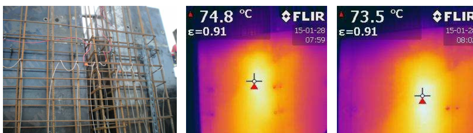
Rys. 7. Usytuowanie grzałek w narożniku konstrukcji. Na zdjęciach termowizyjnych widoczne są obszary, gdzie panowała wysoka temperatura, związana z koncentracją rozmieszczenia grzałek (fot. K. Owczarska)
