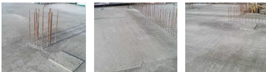
Rys. 12. Zdjęcia powierzchni stropu. Miejsca wychłodzenia betonu mają ciemniejszą barwę (fot. K. Owczarska)
