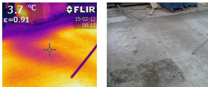
Rys. 13. Z lewej zdjęcie termowizyjne styku w miejscu przerwy roboczej stropu. Po prawej obraz powierzchni stropu. Pola o kolorze granatowym pokazują obszary o temperaturze -3^{\circ}\text{C} , natomiast jasnożółte pola 7^{\circ}\text{C} (fot. K. Owczarska)
