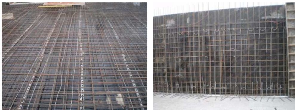
Rys. 4. Rozmieszczenie grzałek: z lewej – w płycie stropowej, z prawej – w ścianie (fot. K. Owczarska)
