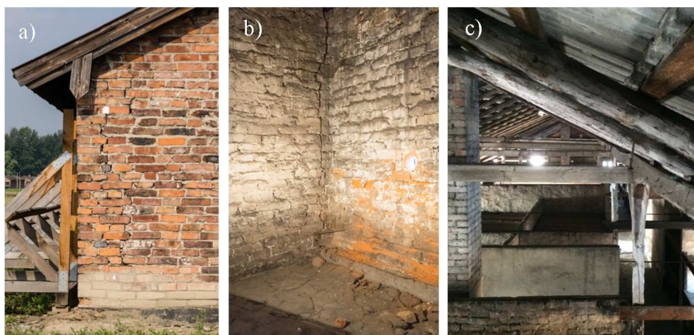
Rys. 5. Uszkodzenia i deformacje konstrukcji baraków więźniarskich, a) typowe uszkodzenia ścian murowych – pęknięcia i zarysowania, b) stan elementów drewnianych więźby dachowej
