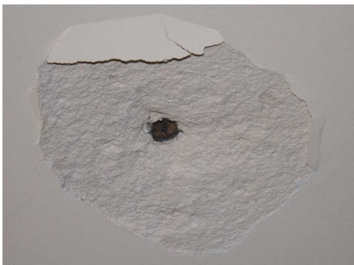
Fot. 5. Widok odspojenia zarysowanego kolistego fragmentu tynku na suficie. Na dnie powstałego krateru widoczne szare podłoże ścianki pustaka z wyraźnym brunatnym wtrąceniem
