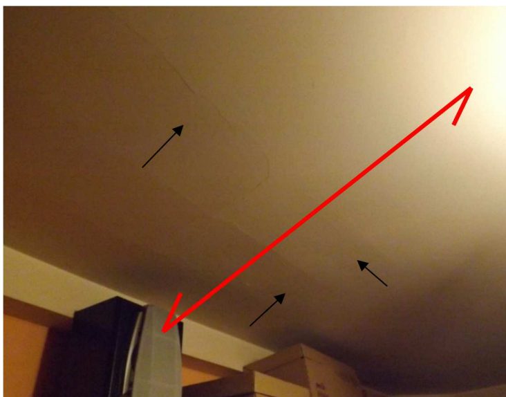
Fot. 2. Sufit w dużym pokoju w mieszkaniu nr A. Rysy na suficie przebiegają prostopadle i równolegle do belek stropowych
