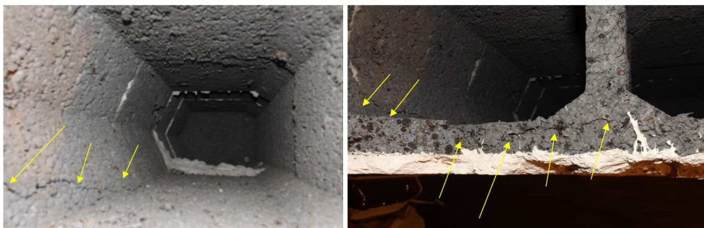
Fot. 6. Pustaki stropowe z widocznymi zarysowaniami wskazującymi na odspajanie się dolnych ścianek
