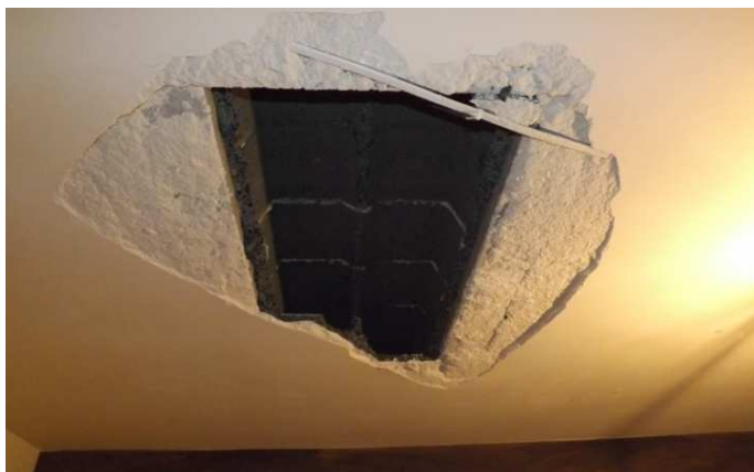
Fot. 1. Fragment sufitu z odspojoną dolną ścianką pustaka stropowego
