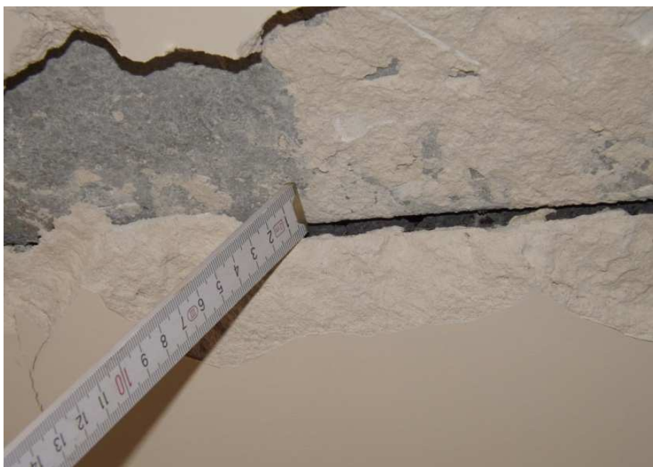
Fot. 4. Sufit w sypialni w mieszkaniu nr A. Odspojenie tynku
