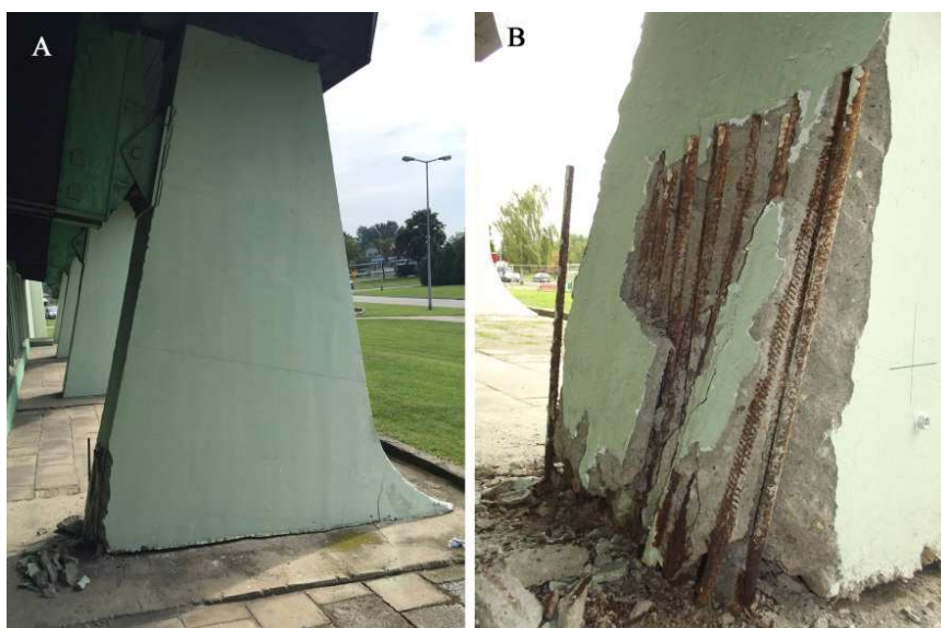
Rys. 7. Uszkodzony słup (A – widok ogólny, B – miejsce inicjacji uszkodzenia)
