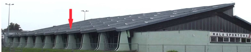
Rys. 6. Zestaw słupów od południa (wskazano uszkodzony słup)
