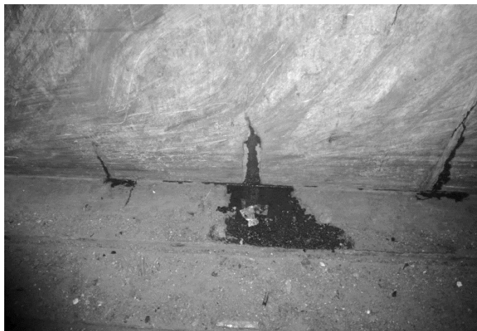
Rys 6. Przeciekające regularne rysy skurczowe w ścianie pomiędzy reaktorami nr 1 i 2
