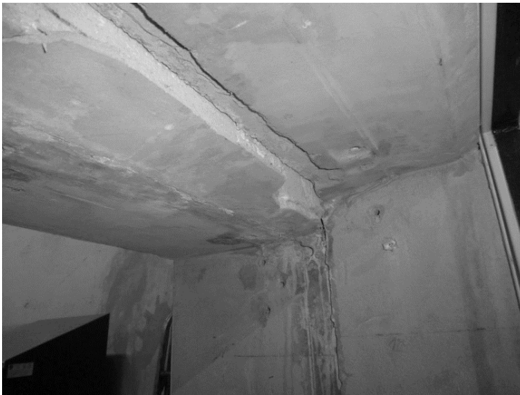
Rys. 2. Uskok nadproża dylatacji w osi B, w przejściu pomiędzy sterownią i wentylatorownią
