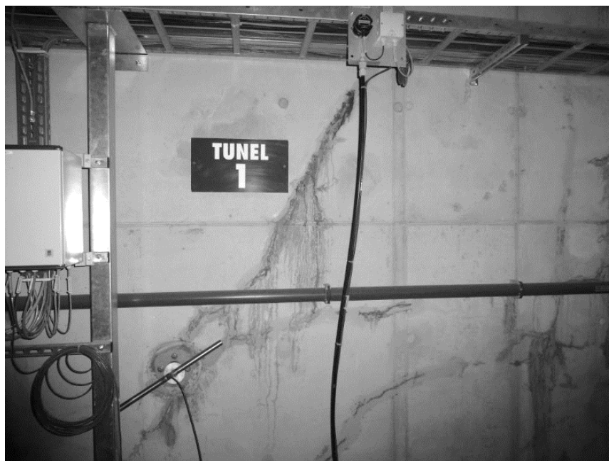
Rys. 4. Zarysowanie ściany w osi 3 reaktora nr 1
