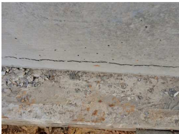
Rys. 3. Rysa w podstawie ściany bez otworów (oś I); widoczne przemieszczenie krawędzi z płaszczyzny ściany
