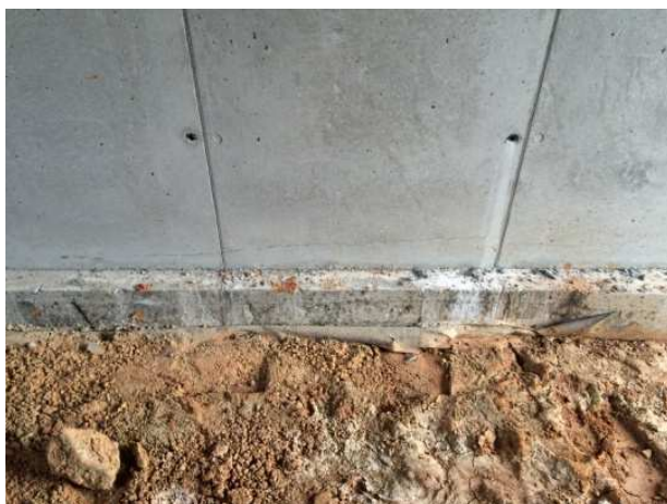
Rys. 4. Rysa w podstawie ściany z otworami (oś 7)
