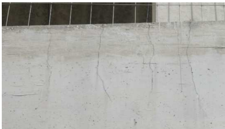
Rys. 14. Zasięg rys we wspornikowej części belki
