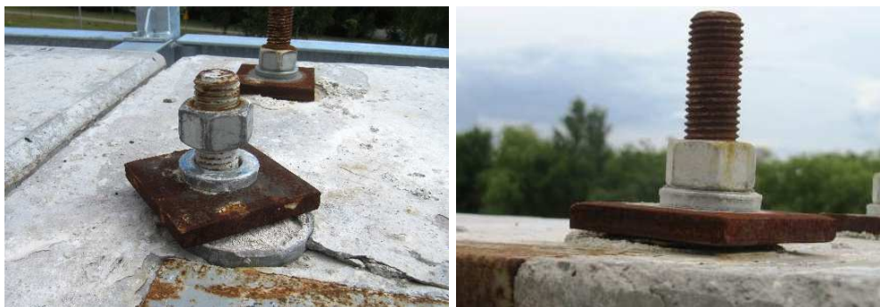
Rys. 7. Widoki góry belek BG-1 przy wewnętrznych (ściskanych) wytykach; wypchnięcie wytyku
