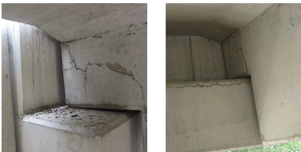
Rys. 6. Przykłady uszkodzeń stref podporowych płyt TT
