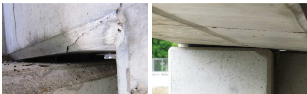
Rys. 8. Zmiażdżenie podkładek elastomerowych pod podciętym zębem płyty TT i pod belką RL
