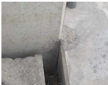
Rys. 11. Uszkodzenia spowodowane dociskiem
