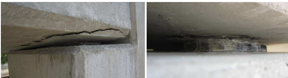
Rys. 9. Uszkodzenia dolnej powierzchni belek RL przy rozciągającym wytyku – zerwanie przyczepności wytyku przy dolnej powierzchni belki
