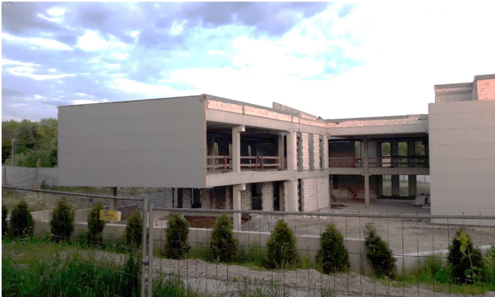
Rys. 15. Zabudowanie ugiętych i zarysowanych belek ze wspornikiem
