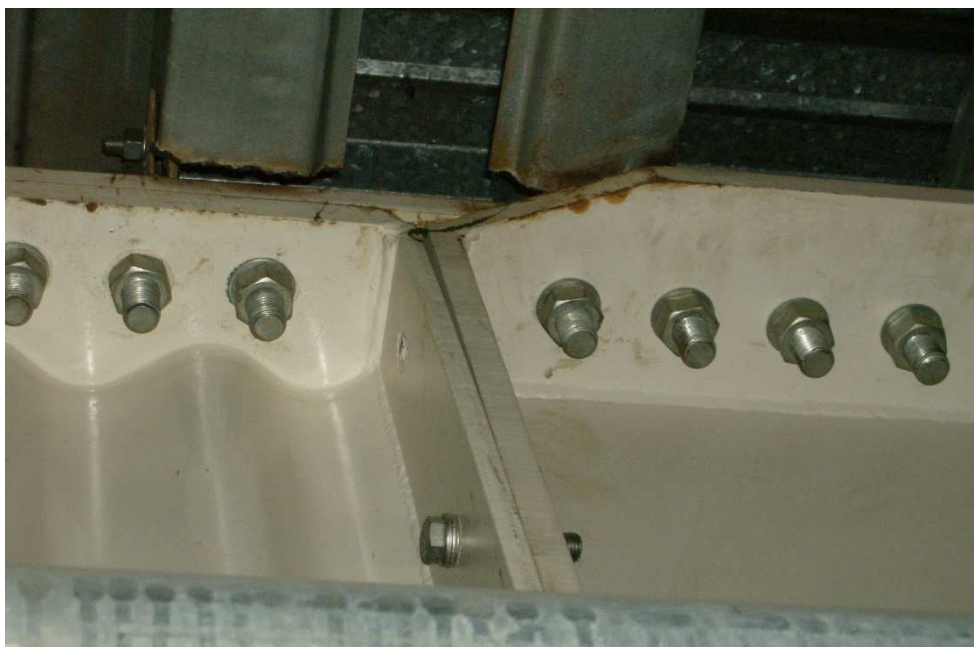
Rys. 2. Rozwiązanie styku pomiędzy elementami montażowymi i widoczne zerwanie śruby w połączeniu blach czołowych rygli ramy
