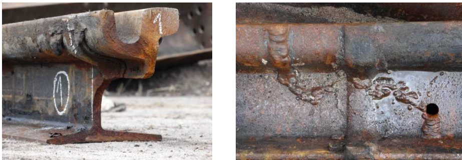
Rys. 1. Pęknięcie szyny tramwajowej i doraźna naprawa
