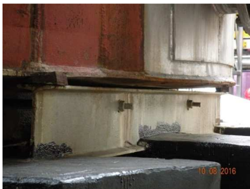
Rys. 6. Wybrzuszenie dna wieży i kliny podpierające pobocznice
