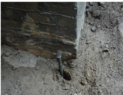
Rys. 7. Wpływ wieloletniego działania kwasu na beton podpór zbiorników
