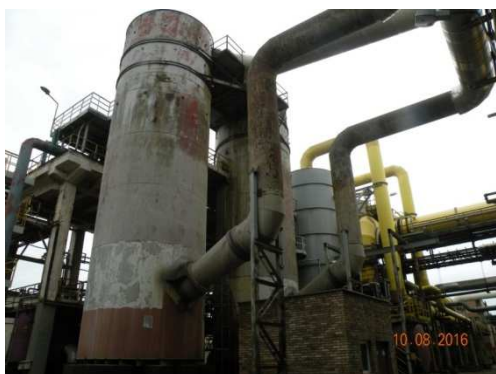
Rys. 1. Widok baterii zbiorników – wież suszących i absorpcyjnych
