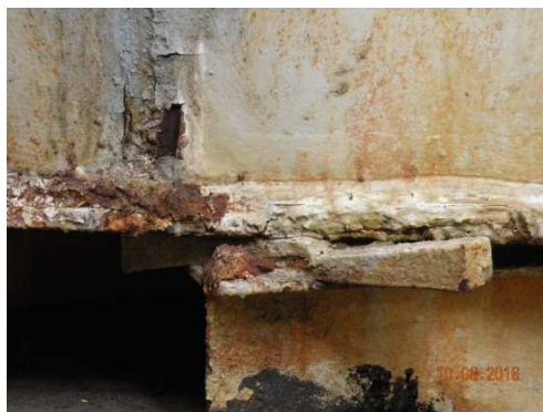
Rys. 5. Korozja spoiny łączącej płaszczy z dnem
