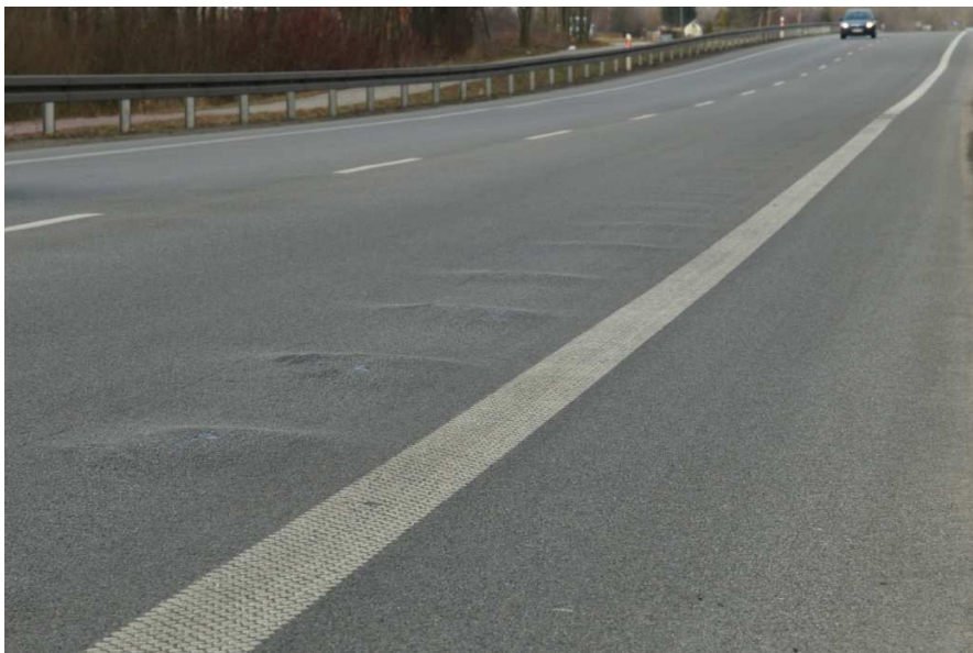
Rys. 2. Widok na uszkodzenia jezdni
