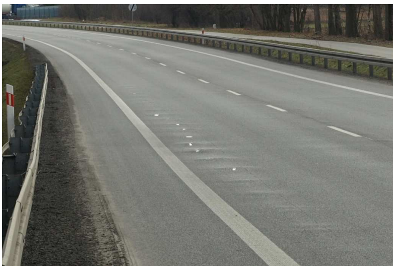
Rys. 1. Widok na uszkodzenia jezdni
