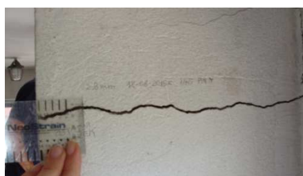
Rys. 9 Pęknięcia filarka międzyokiennego w pomieszczeniu kotłowni (ściana południowa)
