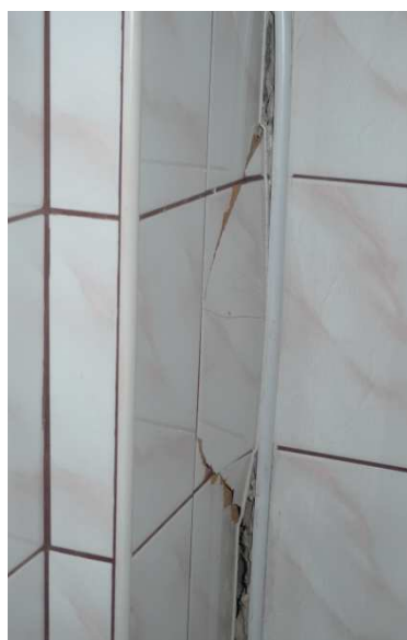
Rys. 14 Odspojenie i deformacje ściany działowej w pomieszczeniu toalet
