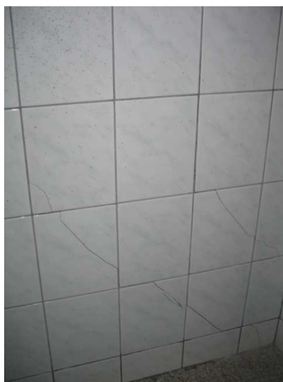
Rys. 10 Rysy ukośne przy posadzce w pomieszczeniu kotłowni (ściana południowa)
