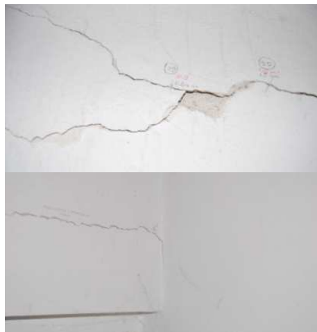
Rys. 12 Widoczne w rysie przesunięcie z płaszczyzny ściany
