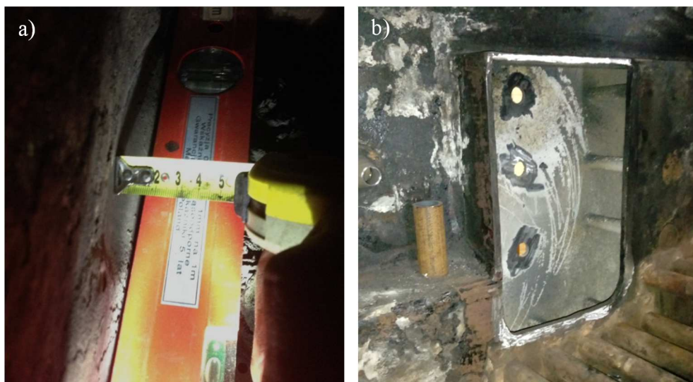
Rys. 3. Uszkodzenie płaszcza wodnego od strony paleniska (a) i widok po wycięciu uszkodzonej blachy (b)
