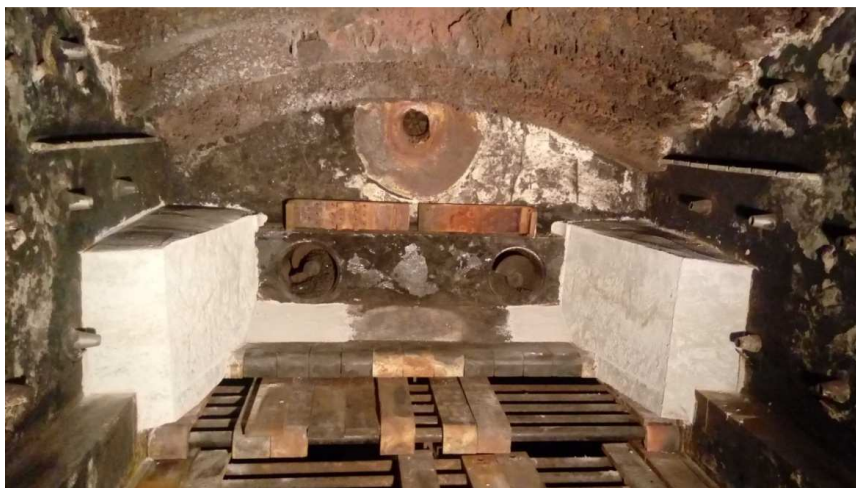
Rys. 4. Zabezpieczenie uszkodzonych blach płaszcza wodnego obudową z szamotu
