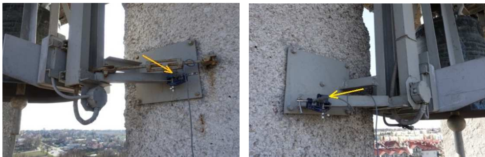
Rys. 6. Sposób mocowania akcelerometrów B200 do zawiesia dzwonów: czujnik nr 1 (z lewej), czujnik nr 2 (z prawej), strzałki pokazują miejsca mocowania akcelerometrów B200
