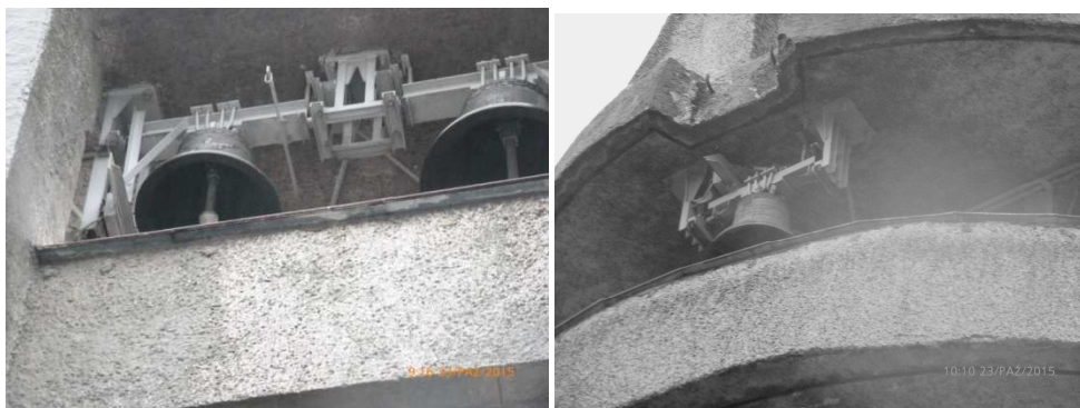
Rys. 4. Dzwony: dwa dzwony na konstrukcji przymocowanej do tarczy stężającej łączącej ściany wieży i do ściany wieży (z lewej) oraz trzeci dzwon podwieszony do tej tarczy
