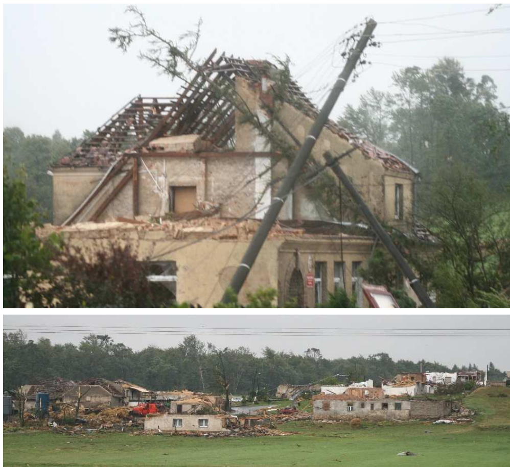
Rys. 2. Przykłady zniszczeń budynków przez trąbę powietrzną – 15.08.2008 r.
