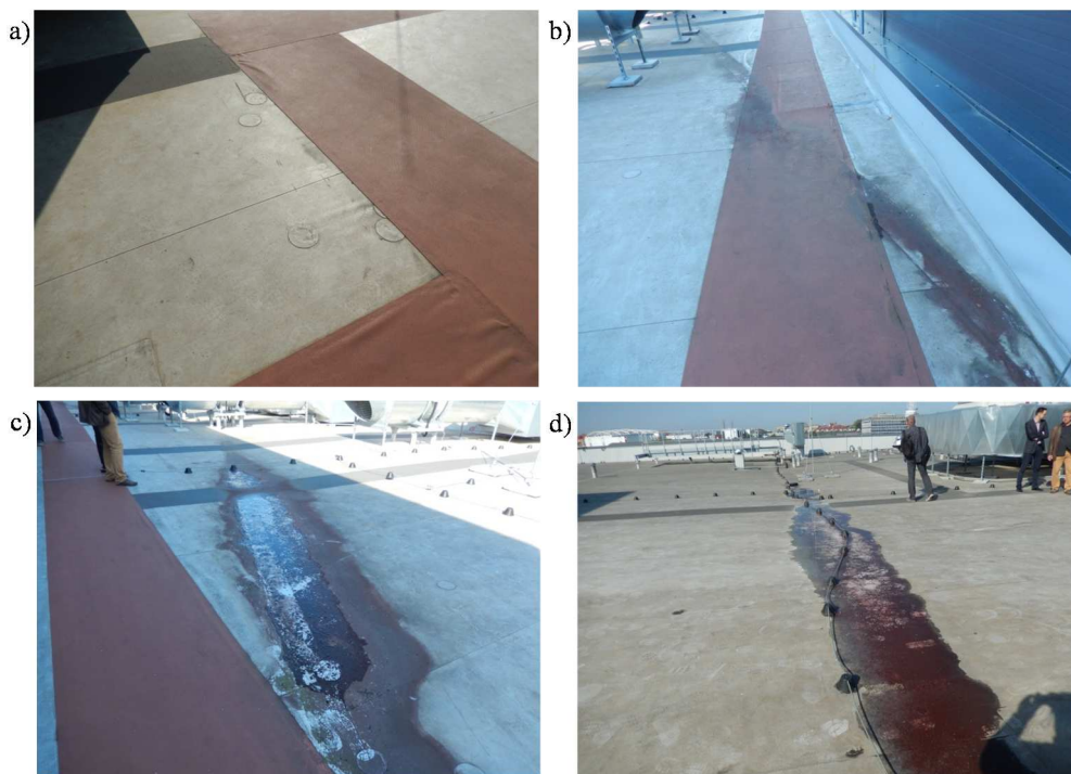
Fot 4. Widok powierzchni dachu w dniu 17.09.2014 r. nad obszarem gdzie miała miejsce awaria. Dach jest wysprzątnięty (jednak nadal lokalnie brudny). Nadal widoczne są zastoiska wody. Instalacja odgromowa nadal jest wykonana niestaranie. Nie zaobserwowano większych konsolidacji wełny mineralnej. Widoczne są ślady licznych drobnych napraw
