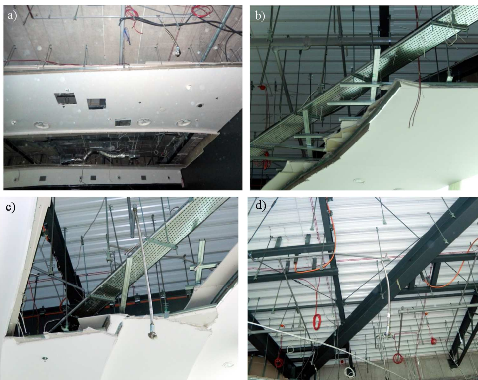
Fot. 2. Widok wnętrza budynku PCC (drugie piętro, rejon awarii) w dniu 9.05.2014. Widoczne uszkodzone fragmenty instalacji tryskaczowej oraz sufitu podwieszonego. Uwagę zwraca optycznie dobry stan techniczny ocalałych fragmentów płyt G-K
