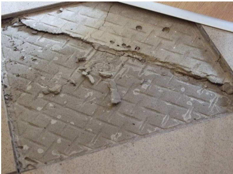
Rys. 3. Osiadanie wylewki cementowej w sąsiedztwie „progu” pozbawionego warstw ściśliwych
