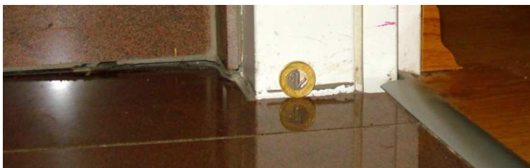
Rys. 1. Rozwarstwienie fugi przy framudze drzwi jako efekt osiadania podłogi
