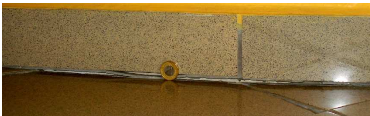
Rys. 2. Rozwarstwienie fugi przy cokole jako efekt osiadania podłogi
