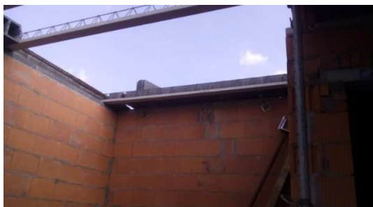
Rys. 8. Miejsce awarii – widoczne fragmenty stropu, które nie uległy zniszczeniu
