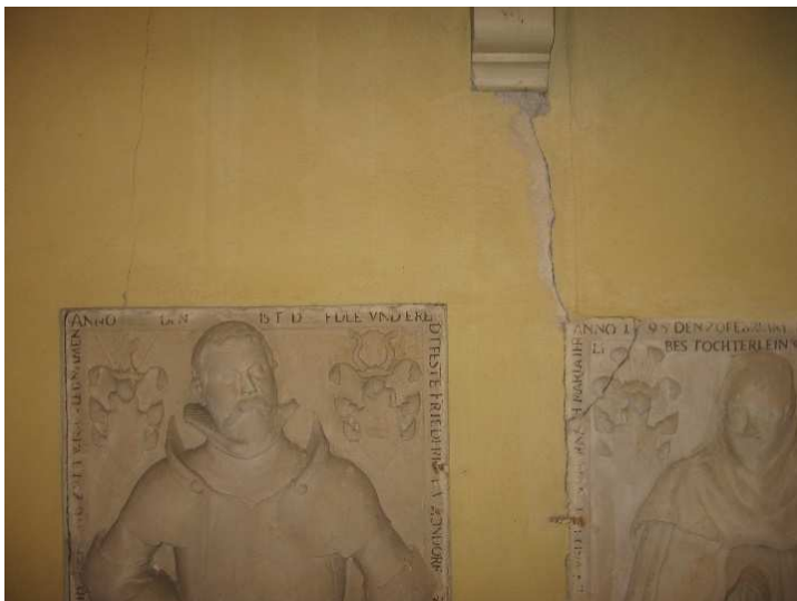
Rys. 4. Wewnętrzna część ściany północno-wschodniej. Dwa pionowe strukturalne pęknięcia ściany wzdłuż słupów
