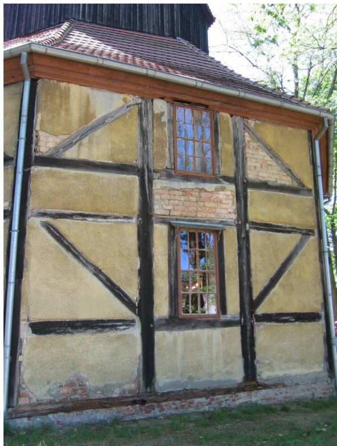
Rys. 3. Fragment elewacji północnej. Skorodowana drewniana konstrukcja słupowo-ryglowa. Skompresowana belka podwalinowa. Zawilgocony cokół i fundament. Rozluźnione wiązanie cegieł, ubytki tynków
