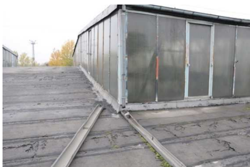
Rys. 15. Uszkodzenia obróbek blacharskich
