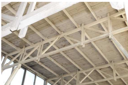
Rys. 11. Pęknięty krzyżulec płatwi kratowej
