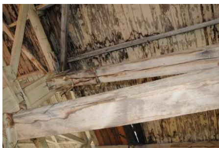
Rys. 9. Zaawansowana korozja biologiczna krokwi, stężeń dachowych i nakładek pasów górnych płatwi kratowych
