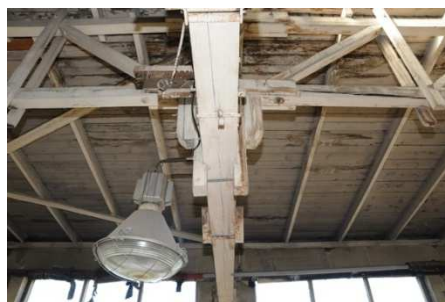
Rys. 10. Pęknięcie pasa dolnego płatwi kratowej
