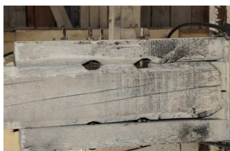
Rys. 8. Brak pierścieni w styku
