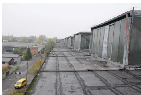
Rys. 18. Zanieczyszczone rynny nawy zachodniej
