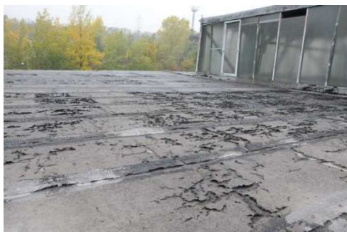
Rys. 13. Uszkodzone pokrycie dachowe
