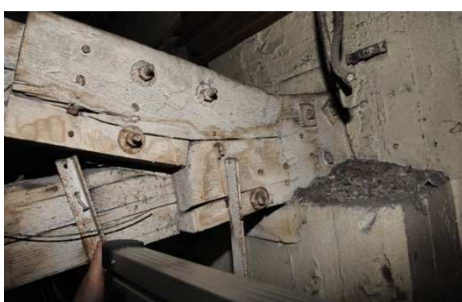
Rys. 7. Pęknięta nakładka węzła podporowego pasa dolnego
