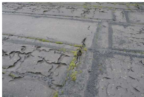
Rys. 14. Uszkodzone pokrycie dachowe
