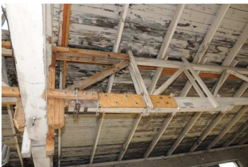
Rys. 12. Niewłaściwie wykonana naprawa pasa dolnego płatwi kratowej
