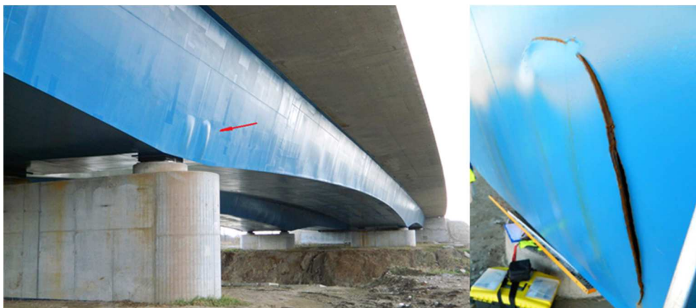
Rys. 3. Widok z boku na obiekt (po lewej) i zbliżenie na uszkodzenie środnika nad filarem (po prawej)
