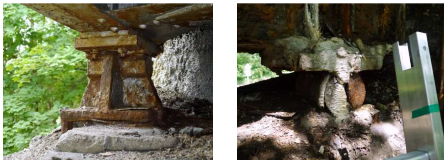
Rys. 11. Korozja łożysk pod belką skrajną
