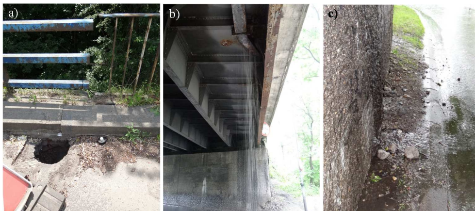
Rys. 7. Stan balustrad i gzymsów (a); niedrożność odwodnienia (b); ciekąca woda po przyczółku (c)
