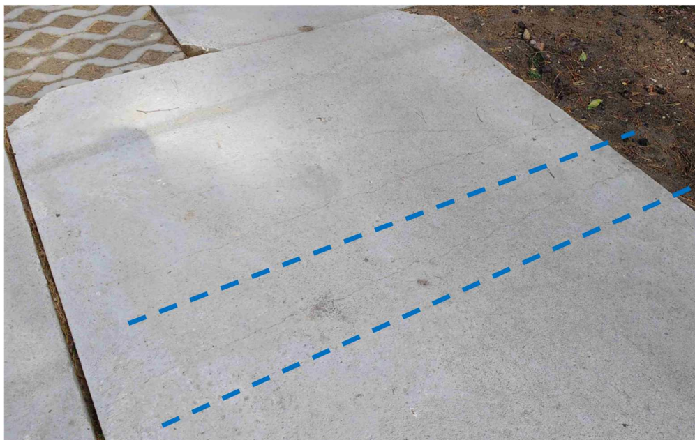
Rys. 3 Ułożona płyta z dwiema rysami (przebieg rys zaznaczono przerywaną linią)
