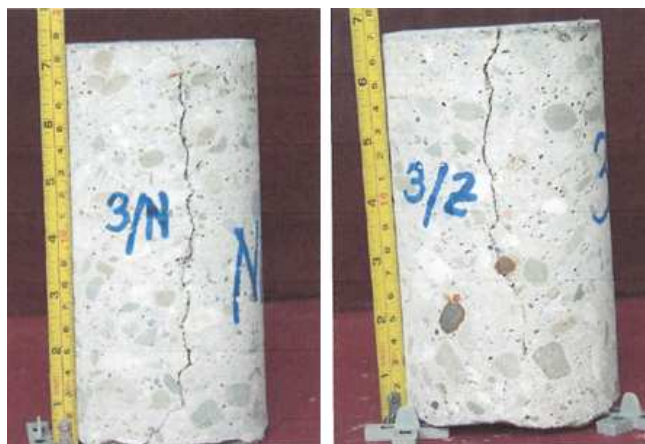
Rys. 3. Odwiert rdzeniowy 3/N oraz 3/Z z widocznym przebiegiem rysy
