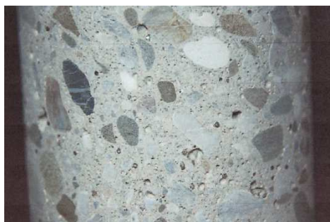
Rys. 2. Struktura betonu próbki 3/Z
