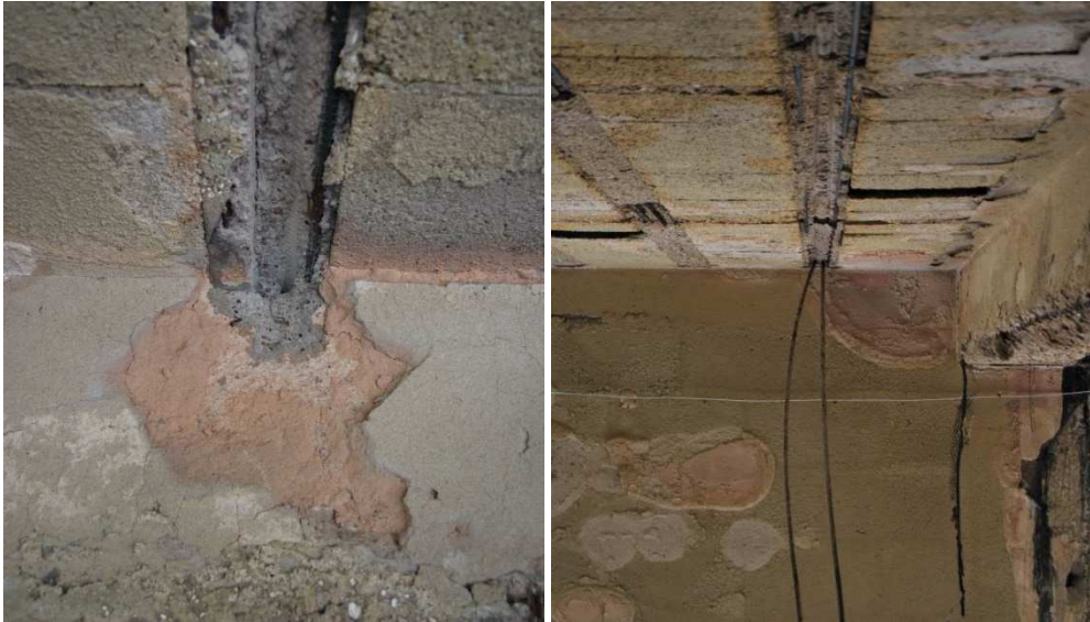
Rys. 6 Wysunięcie prętów zbrojenia podłużnego w wyniku niewystarczającej długości zakotwienia na ryglu ramy
