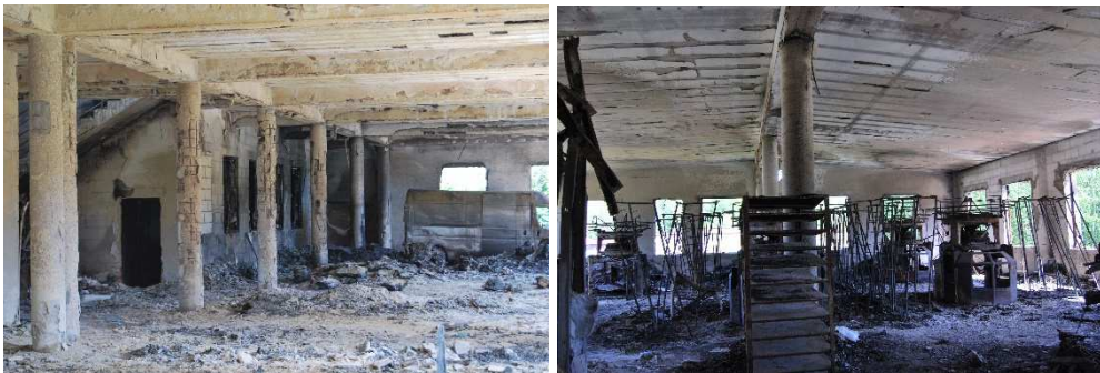
Rys. 2. Ogólny stan pomieszczeń po pożarze na parterze i piętrze budynku
