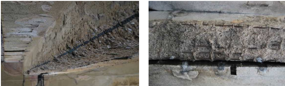
Rys. 7 Uszkodzenie otuliny belki poprzecznej (w osiach cyfrowych)
