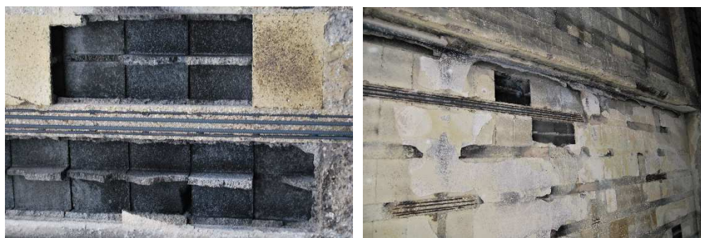
Rys. 5 Uszkodzenie otuliny belek stropu Teriva, dolnych półek pustaków oraz belek
