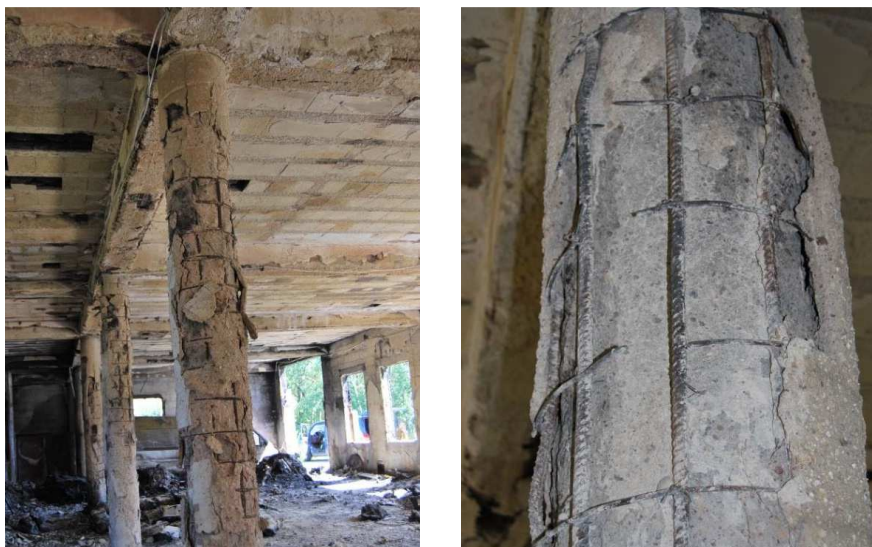
Rys. 3. Zniszczenie betonowej otuliny słupa
