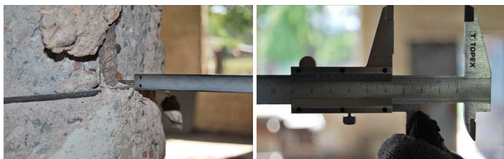
Rys. 4. Uszkodzenie otuliny słupa
