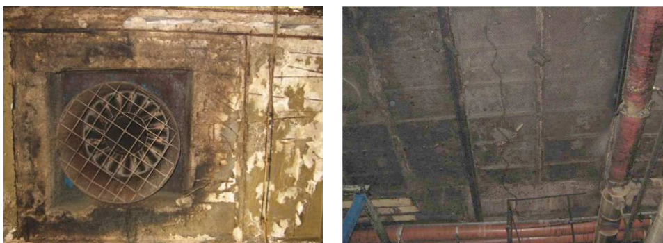
Rys. 10, 11. Konstrukcja stropodachu – widoczne ubytki otuliny, zaawansowana korozja prętów zbrojeniowych, liczne spękania i zarysowania
