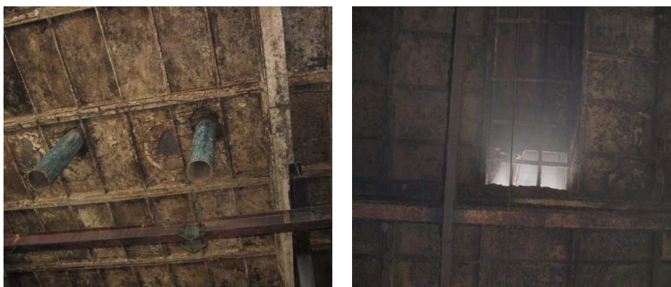
Rys. 8–9. Konstrukcja stropodachu – widoczny brązowo-czarny nalot i ślady korozji
