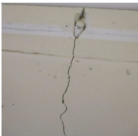
Rys. 6. Belka stropowa – widok pęknięcia w odległości 3,0 m od podpory
