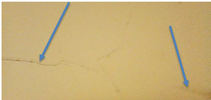
Rys. 7. Płyta stropowa od strony spodniej – rysa biegnąca prostopadłe do podparcia stropu
