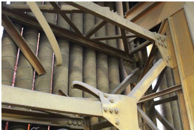
Rys. 10. Uszkodzenie konstrukcji stężenia międzysłupowego
