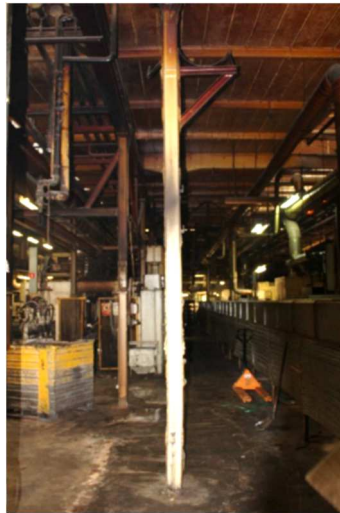
Rys. 6. Widok na znacznie zdeformowany słup podpierający ustrój dachowy
