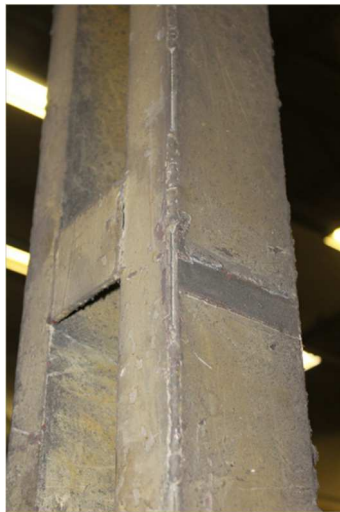
Rys. 7. Nietechnologicznie wykonana przewiązka słupa z pękniętą spoiną
