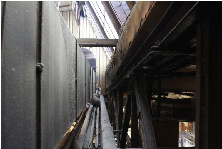
Rys. 4. Widok znacznie przeciążonej kratownicy na skutek niezamierzonego w projekcie obciążenia podwieszonymi instalacjami technologicznymi (rejon nr 4 na rys. 3)
