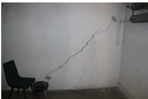
Rys. 3. Wskrośne spękanie ściany nośnej w piwnicy
