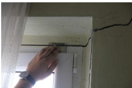
Rys. 7. Spękanie ściany w sąsiedztwie otworu okiennego i deformacja stolarki
