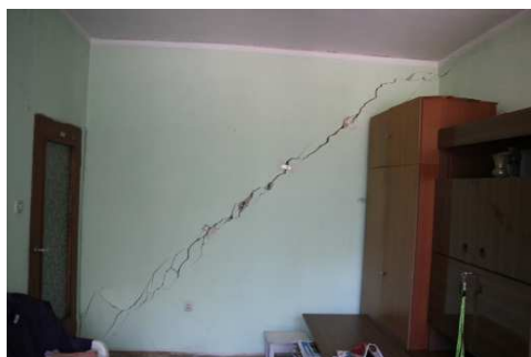
Rys. 4. Wskrośne spękanie ściany działowej na parterze
