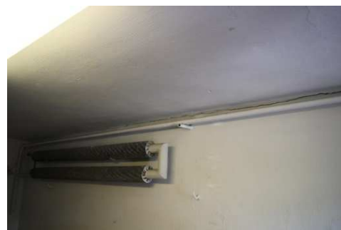
Rys. 6. Pozioma rysa pomiędzy tarczą stropową a ścianą
