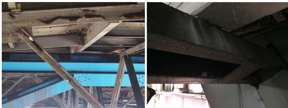
Rys. 7. Przykłady wybranych kolizji skratowania zastrzału z elementami konstrukcyjnymi budynku nadszybia
