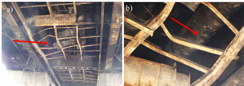
Rys. 6. a), b) Widoki zdeformowanych elementów drugorzędnych stalowej konstrukcji Mostu Łazienkowskiego w miejscu powstania pożaru wraz z widoczną magistralą wodociągową, oznaczoną czerwoną strzałką
