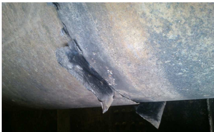
Rys. 7. Widok widocznego na płaszczu z blachy ocynkowanej miejsca pomierzonego termicznego przemieszczenia rurociągu na skutek pożaru Mostu Łazienkowskiego
