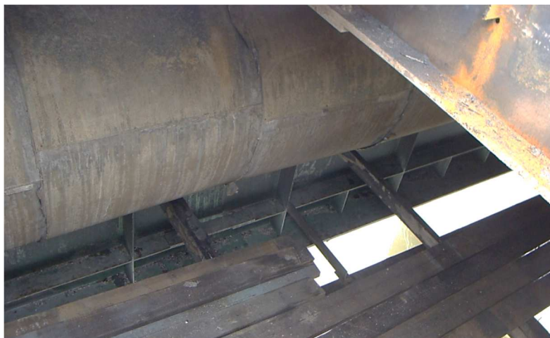
Rys. 4. Widok uszkodzonego podczas pożaru drewnianego pomostu technicznego w przestrzeni konstrukcji mostu przy magistrali wodociągowej
