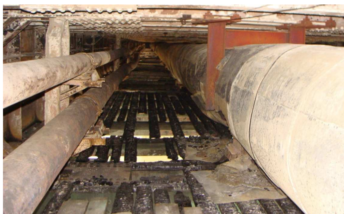
Rys. 3. Widok spalonego podczas pożaru drewnianego pomostu technicznego w przestrzeni konstrukcji mostu przy magistralach gazowych i ciepłowniczej
