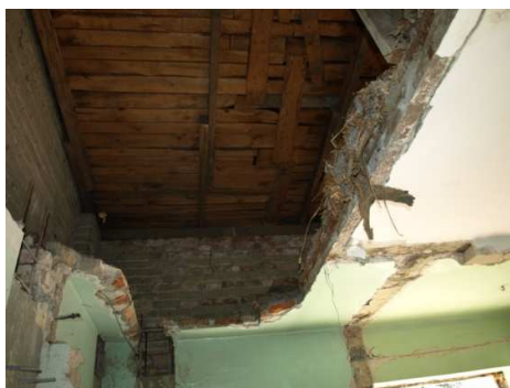
Rys. 10. Zawalone skrajne pasmo stropu. Widok od strony południowo wschodniej
