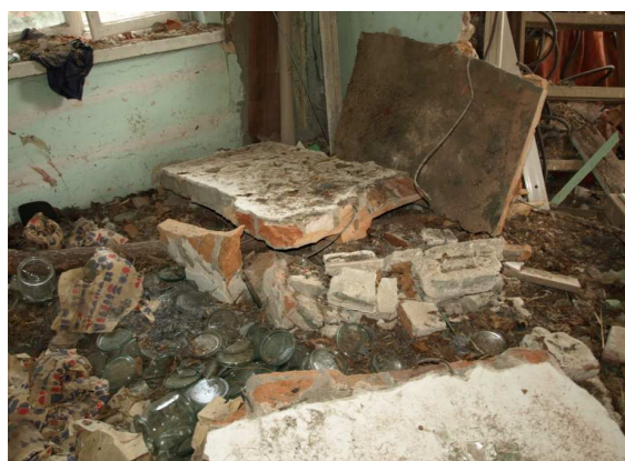
Rys. 11. Fragmenty zarwanej płyty ceramicznej
