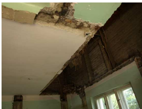
Rys. 9. Zawalone skrajne pasmo stropu. Widok od strony północno zachodniej
