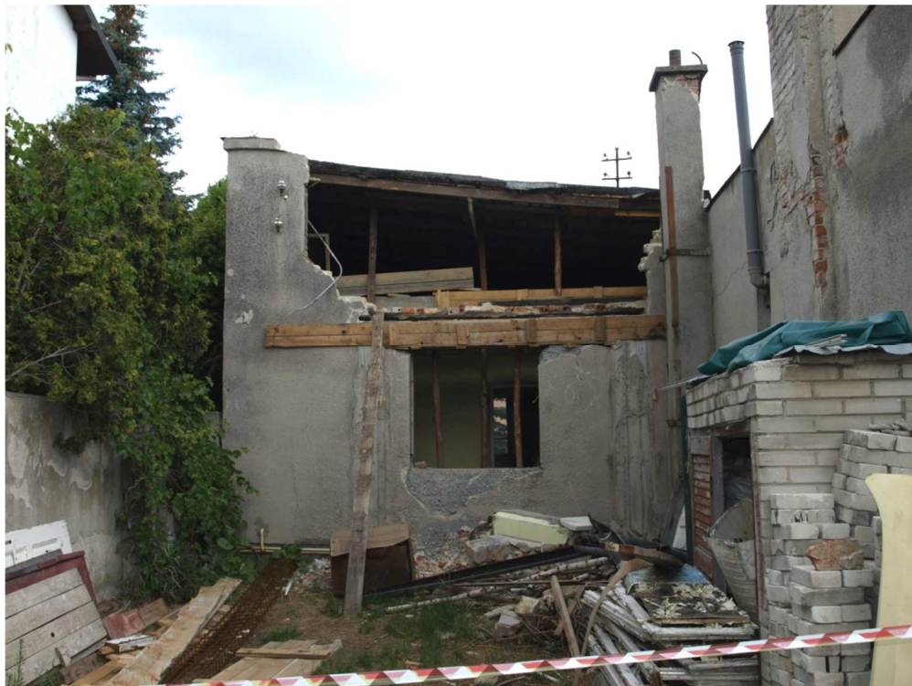
Rys. 7. Zawalona górna część ściany szczytowej
