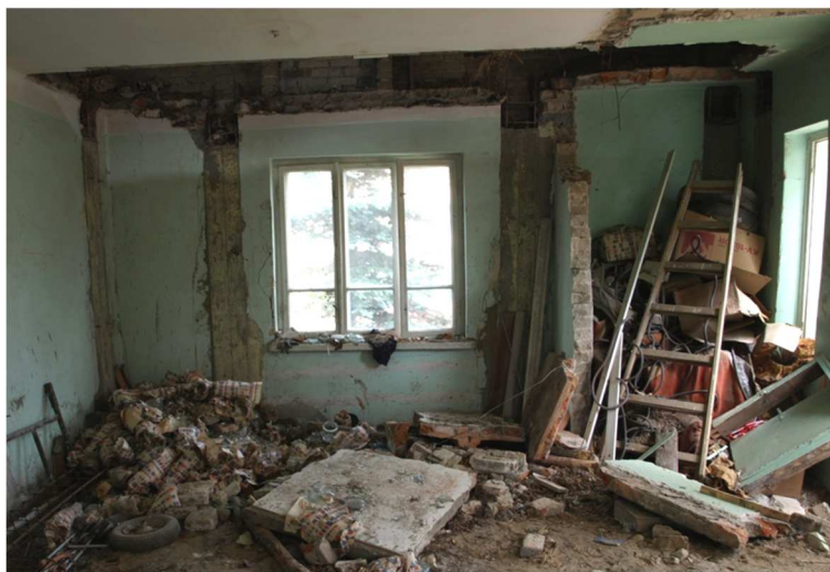
Rys. 8. Zawalone skrajne pasmo stropu
