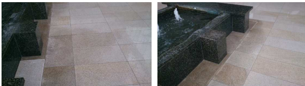
Rys. 9. Przebarwienia kamiennych płyt posadzki w miejscu zwiększonej wilgotności kamienia wokół fontanny
