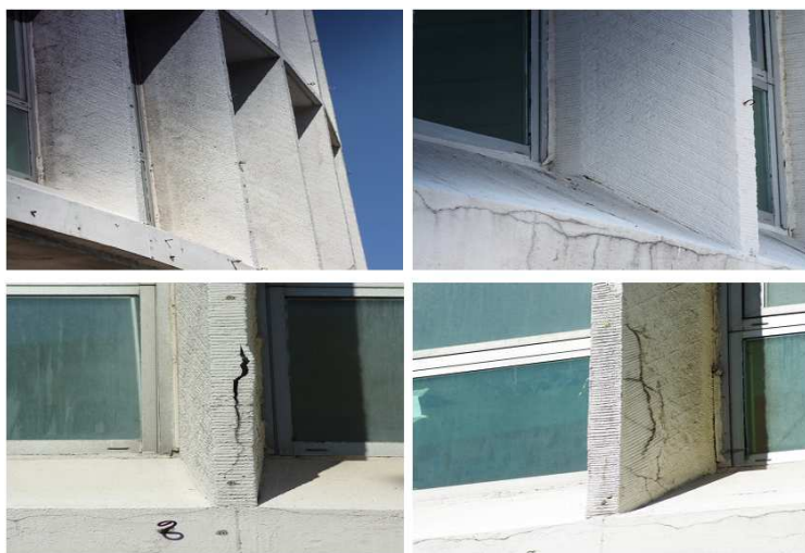
Rys. 7. Uszkodzenia z inwentaryzacji przed remontem Okrągłaka w 2012 roku – typowe uszkodzenia elementów elewacji budynku: rysy i spękania na powierzchni podokienników i belki obwodowej; rysy i pęknięcia betonu (nawet na całą grubość otuliny i z odsłonięciem zbrojenia) na elementach pionowych („żyłtkach”); rysy na styku elementów poziomych i pionowych
